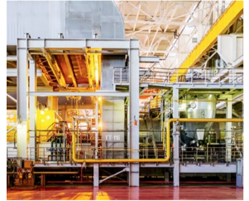
Оборудование парогазового энергоблока № 11 ПГУ-450
