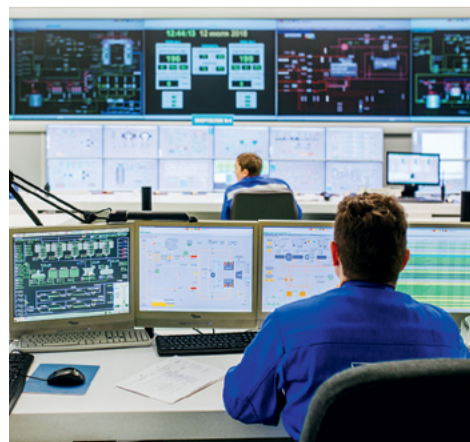
На центральном щите управления ТЭЦ-27
