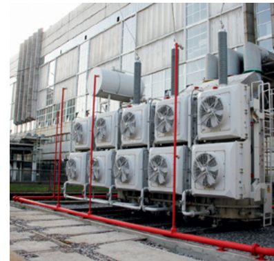
Мощность введенного трансформатора Т-98 – 400 МВА, напряжение высокой стороны – 220 кВ
