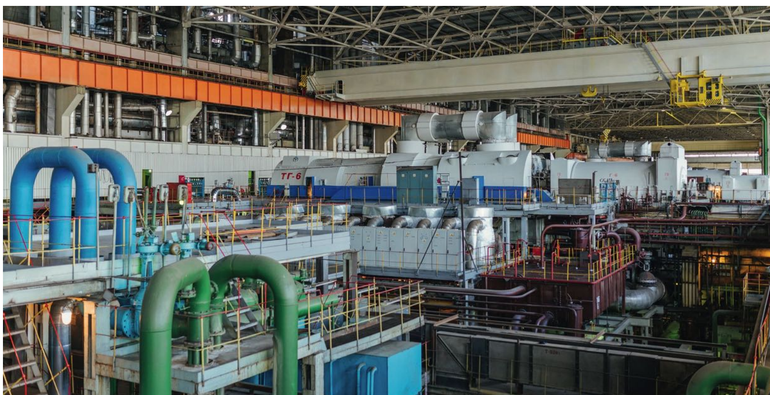
На ТЭЦ-23 в этом году планируется провести капитальный ремонт энергоблоков № 6 (на фото) и № 7
