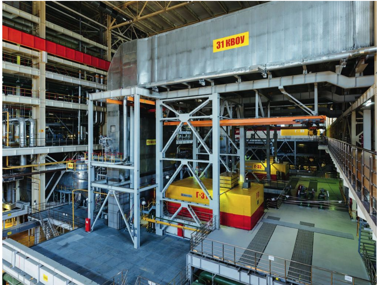
Энергоблок № 3 ПГУ-450 ТЭЦ-27
