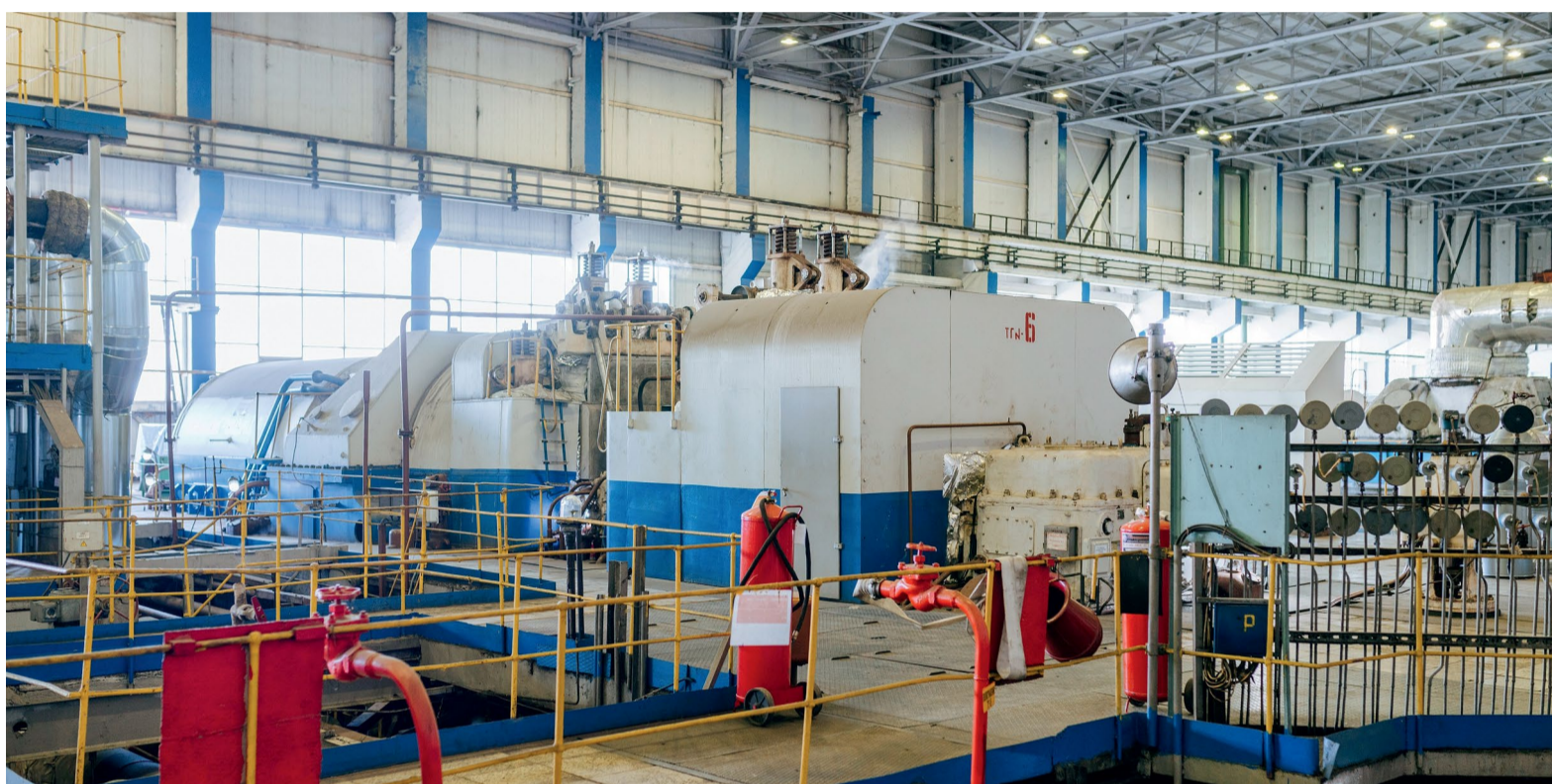
На турбогенераторе ТГ-6 ТЭЦ-22 в ходе ремонтной кампании заменены рабочие лопатки ротора высокого давления, проведены работы по нормализации тепловых расширений с заменой металлофторопластовой ленты
