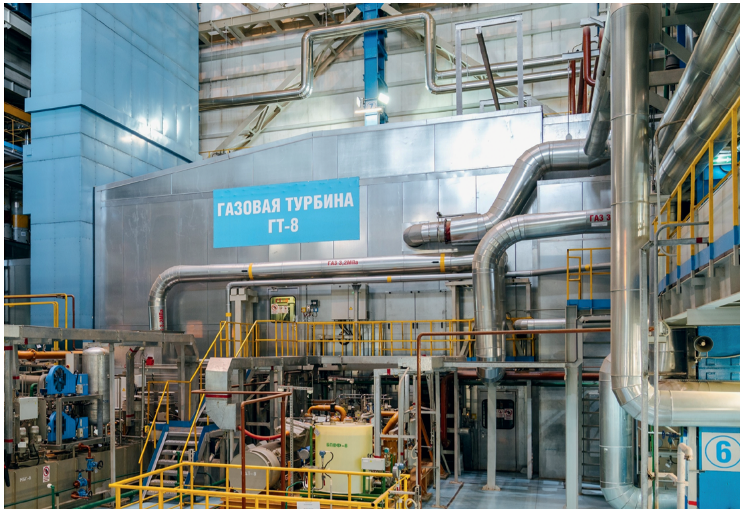
На ПГУ-420 ТЭЦ-16 в июле – августе пройдут главная инспекция газовой турбины SGT5-4000F (на фото), средняя инспекция паровой турбины SST5-5000, средние инспекции генераторов газовой и паровой турбин
