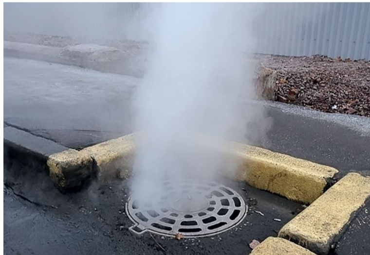
Парение из люка может указывать на повреждение тепловой сети
