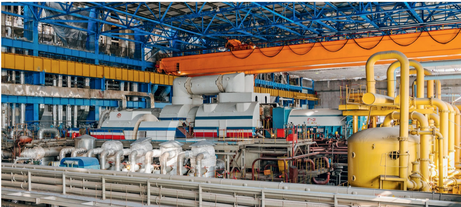
Модернизация БЛ-3 ТЭЦ-25 предполагает замену теплофикационной паровой турбины Т-250 с увеличением мощности с 250 до 259 МВт
