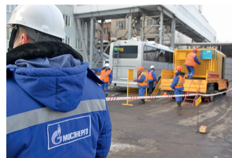
Совместно с МОЭК в прошедшем отопительном сезоне проведено 10 контрольных объектовых противоаварийных тренировок
