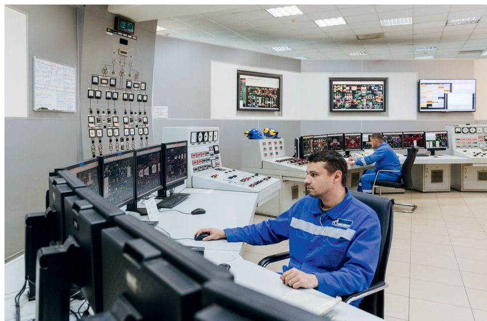
ТЭЦ-21 – крупнейшая электростанция Мосэнерго по показателю установленной тепловой мощности. В зоне ее тепловых нагрузок проживает более 3 млн человек
