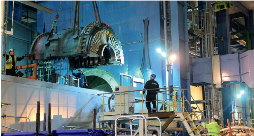
По итогам проведенных в конце 2018 года работ установленная мощность энергоблока ПГУ увеличилась до 445 МВт
