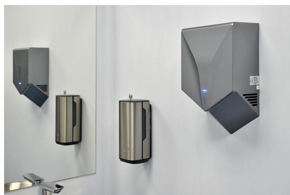
Обновленные санитарно-бытовые помещения ТЭЦ оборудованы современной техникой
