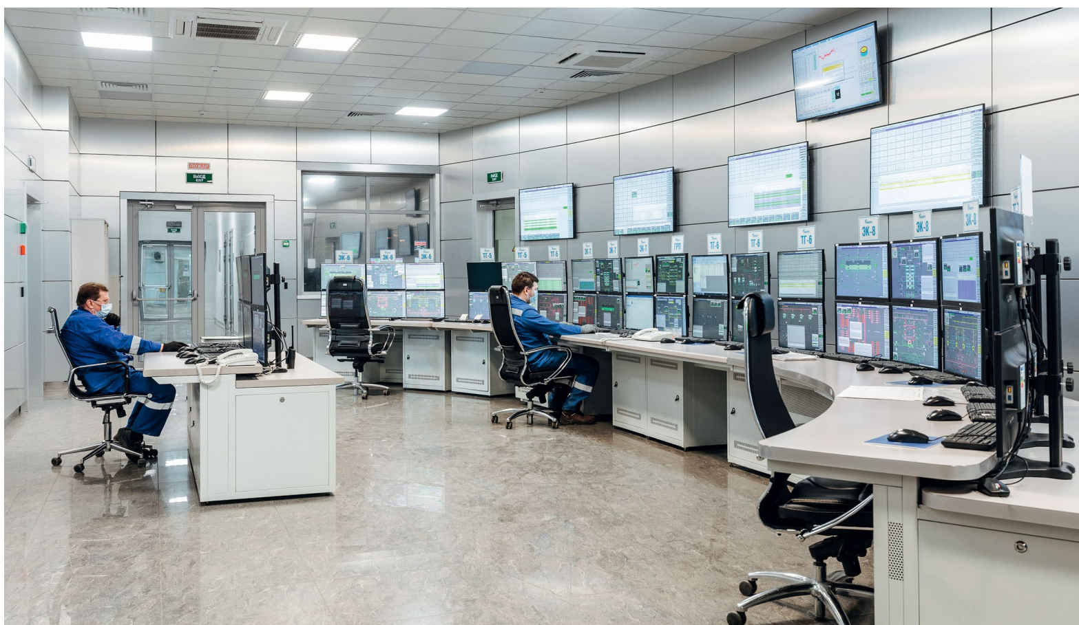
Блочный щит управления котлами и турбинами № 5–7 ТЭЦ-16, февраль 2021 года
