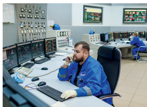
На щите управления энергоблоками № 8–9, 2020 год
