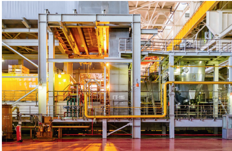
Газотурбинная установка ГТ-11Б, работающая в составе ПГУ-450Т
