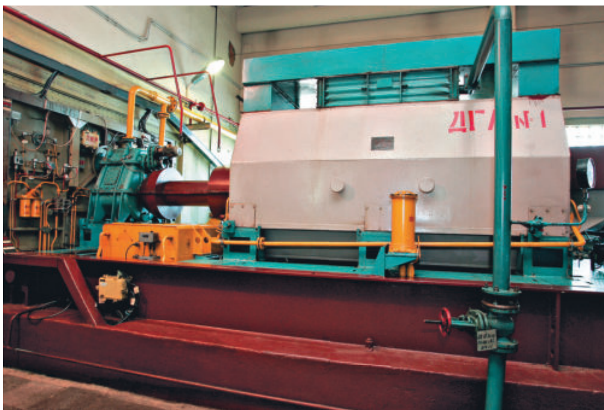
Детандер-генераторный агрегат № 1 на ТЭЦ-21
